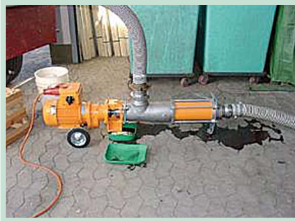
Fig. 63: Bomba para transportar la masa fermentada a la prensa.
